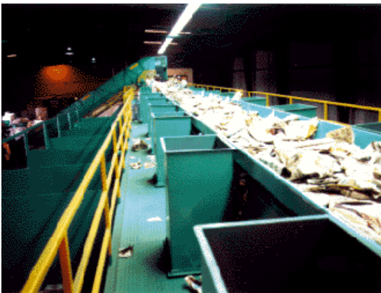
Εικόνα 10.5 Γραμμή χειροδιαλογής μονάδας ανάκτησης υλικών.
