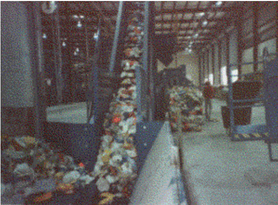
Εικόνα 10.4 Χοάνη υποδοχής των υλικών και ταινιόδρομος.
