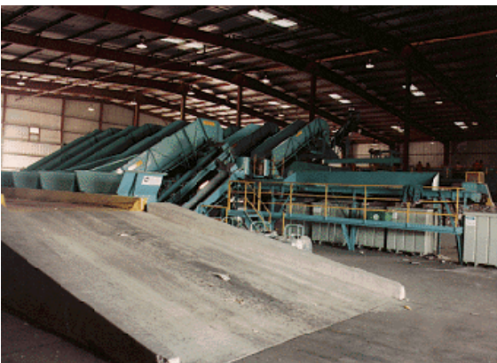
Εικόνα 10.3 Χώρος ζύγισης και χόανες υποδοχής μιας μονάδας ανάκτησης υλικών.
